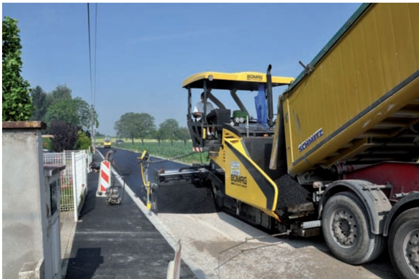
Fin du chantier dans la rue de la diligence, avec de nouveaux trottoirs et pose d'un nouveau revêtement sur la chaussée
